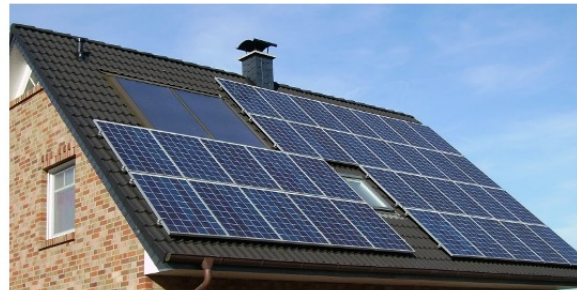
Un toit avec des cellules solaires.
